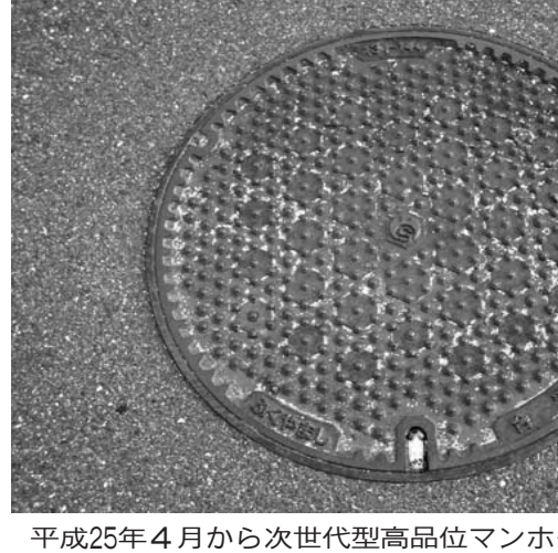
平成25年4月から次世代型高品位マンホールふたを採用
