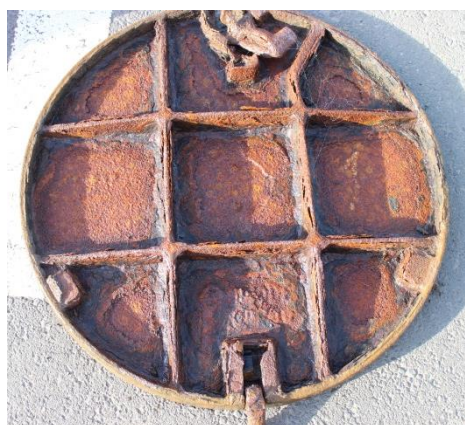
図 1-1. 腐食により強度が低下した蓋
